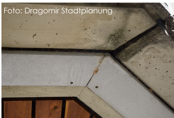
Abbildung 4: Spalten in der Betonverkleidung am Bestandsgebäude der Schule
