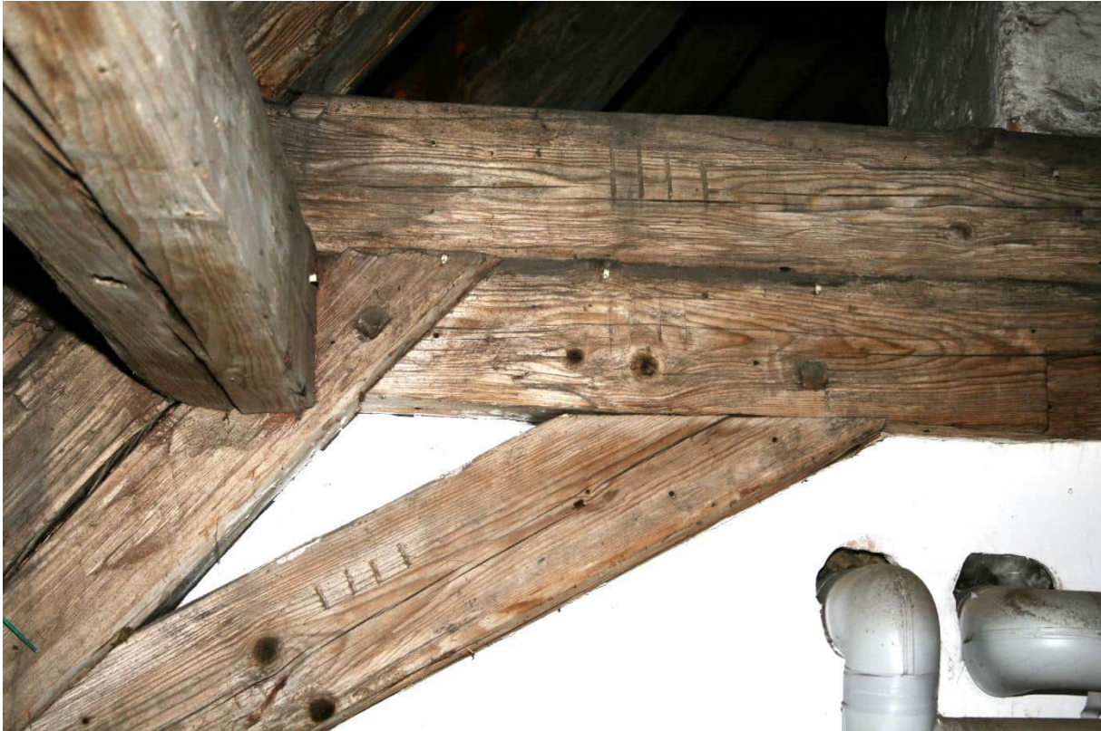
Bild Nr. 127 DG2, Raum Nr. 4.01 nach Norden: Ausschnitt Bundachse 2 Abbundzeichen IIII= von Süden gezählt ist es das 4. Sparrenpaar (siehe auch Bild Nur 131); Abbundzeichen =eingekerbte, römische Ziffernfolge;
