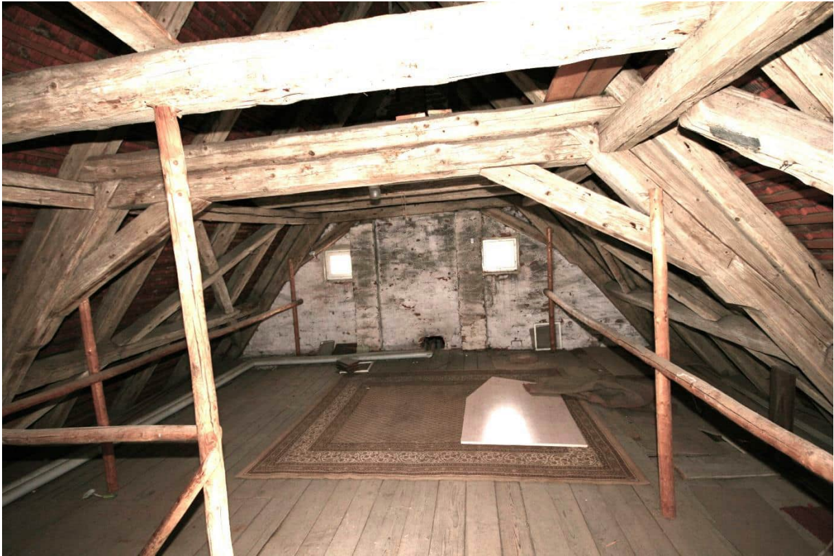
Bild Nr. 121 DG2, Übersicht Raum Nr. 4.01 nach Norden: Liegender Kehlbalkenstuhl wie DG1 mit fünf Binderpaaren; die Binder laufen konisch zu und sind ca. auf halber Höhe abgesetzt; die mittig ansetzenden Büge sind mit Bündelbalken und Stuhlsäule verzapft; die Kehlbalken sind an das Sparrenpaar geblattet und mit Holznägeln gesichert; die Sparrenpaare sind im First miteinander verzapft;
