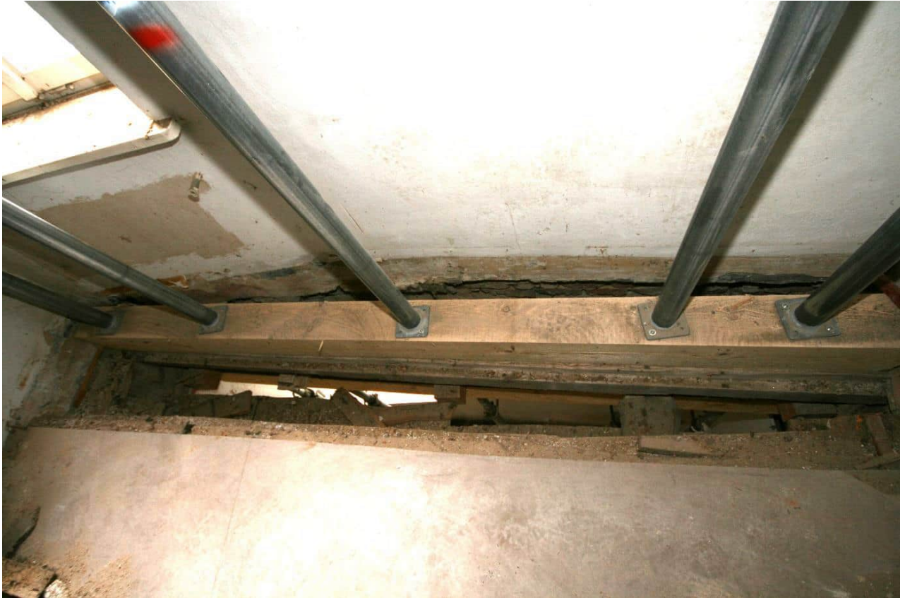
Foto Nr. 27 OG, Raum Nr. 1.07 nach Osten: Statische Sicherung wie vor; Blick auf Balkenlage über EG;
