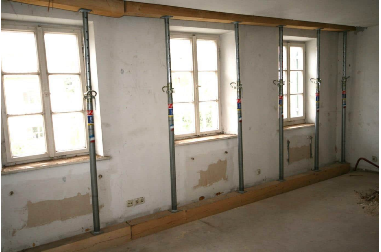
Foto Nr. 23 OG, Übersicht Raum Nr. 1.09 nach Nordwesten: Boden und Decke wie vor;
