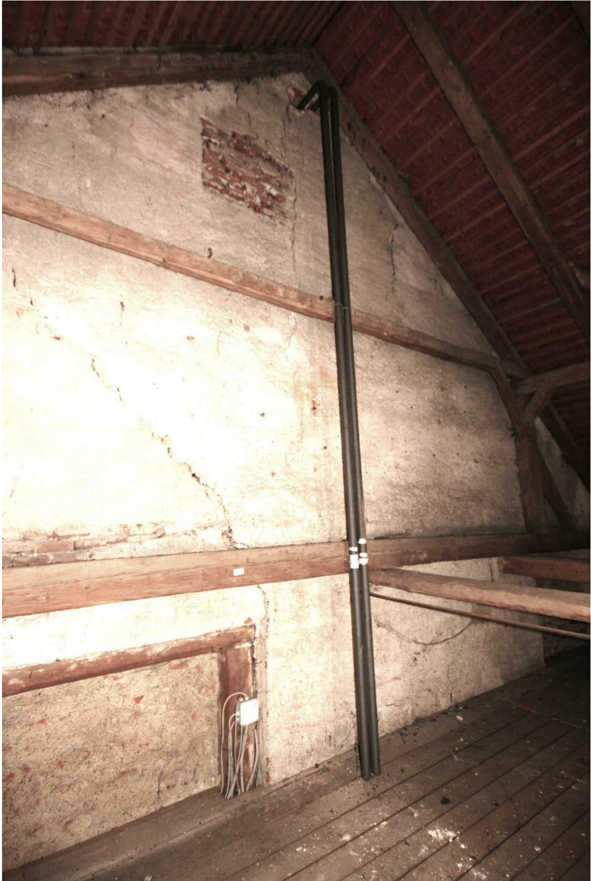
Foto Nr. 41 R.1.11 nach Südwesten: verputzte, südliche Wandscheibe mit Rissbildungen;
