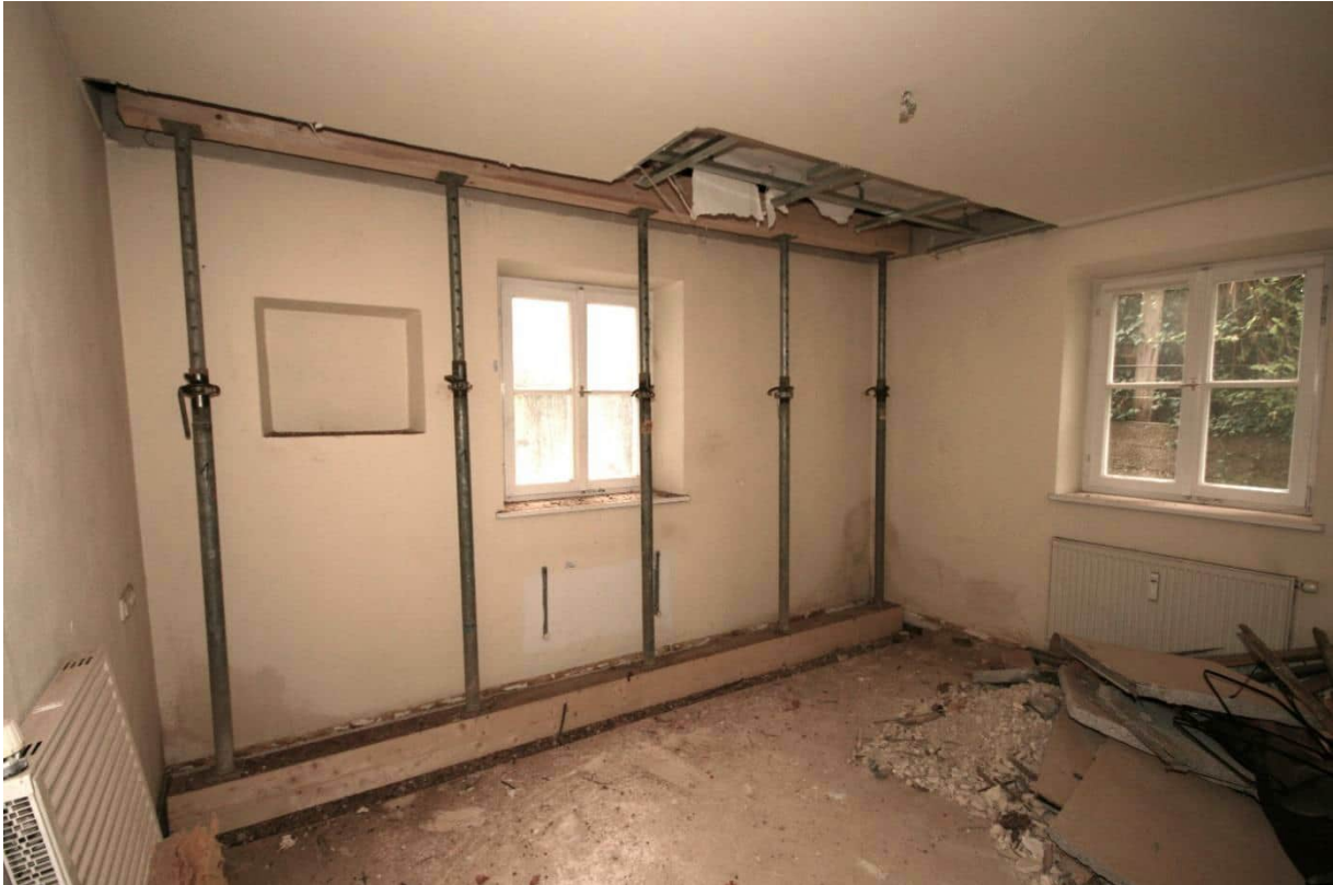
Foto Nr. 60 EG, Übersicht Raum Nr. 0.04 nach Südosten; Hintergrund: Statische Präventivmaßnahmen zur Gebäudesicherung;
