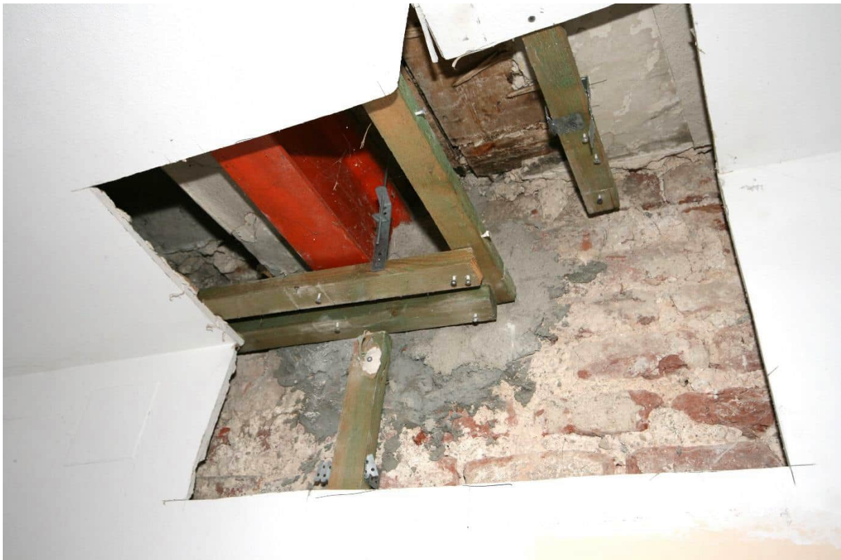
Foto Nr. 69 EG, Wand-/Deckenausschnitt nach Süden: Deckenkanal mit Eisenträger unter Gipskartondecke;
