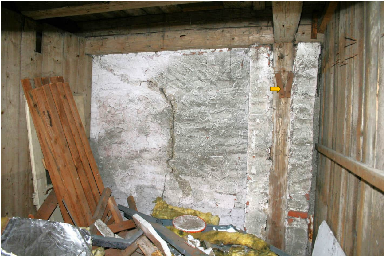
Foto Nr. 111 DG1, Raum Nr. 3.04 nach Norden: Ausschnitt Nordgiebel mit starkem Mauerwerksriss, Mittelstütze Bundachse 5: die Stütze ist in Wandverstärkung (Pfeiler) eingemauert und offenbar über Eisen mit der Außenwand gesichert ?? (Pfeil);
