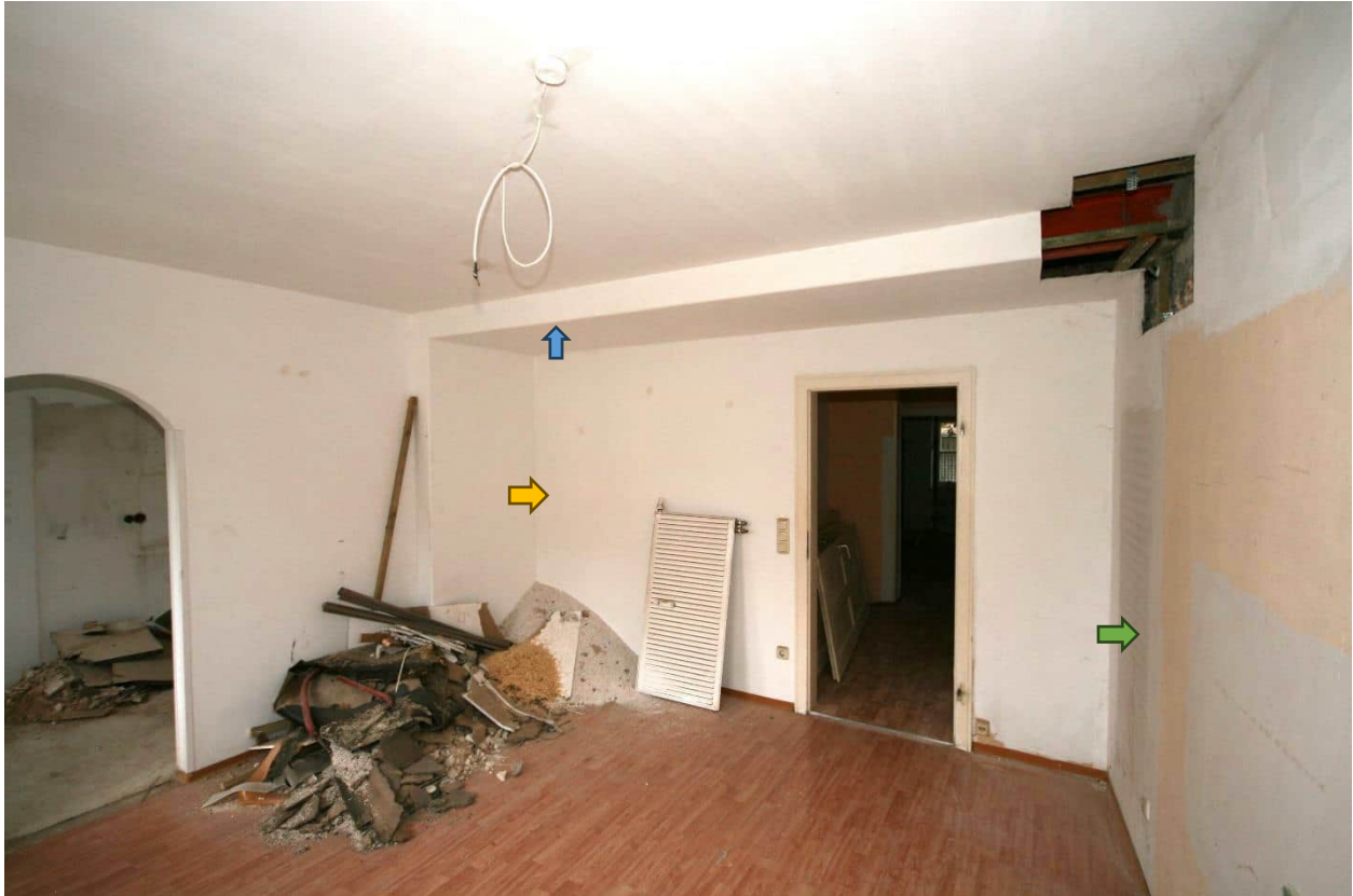
Foto Nr. 68 EG, Übersicht Raum Nr. 0.11 nach Südosten; Boden: Stabparkett, Decken Gipskarton unter Putzdecke; Pfeil gelb: Gipskartonwand; Pfeil grün: Wand gemauert (Vollziegel) unter Gipskarton; Pfeil blau: Siehe nachfolgendes Foto Nr. 69;
