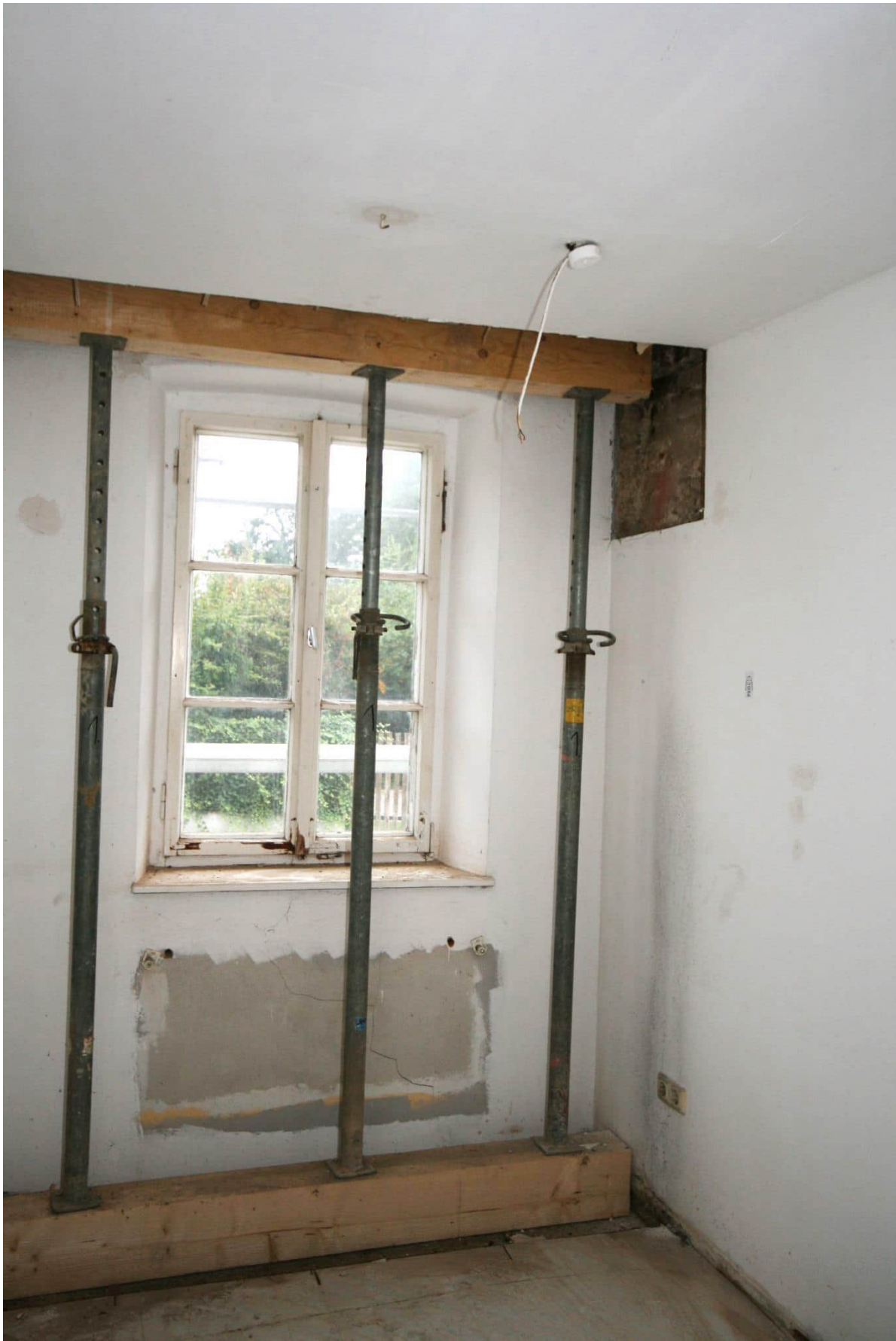
Foto Nr. 70 EG, Übersicht Raum Nr. 0.10 Westen: Abstützungsmaßnahmen für Deckenbalken wie vor;
