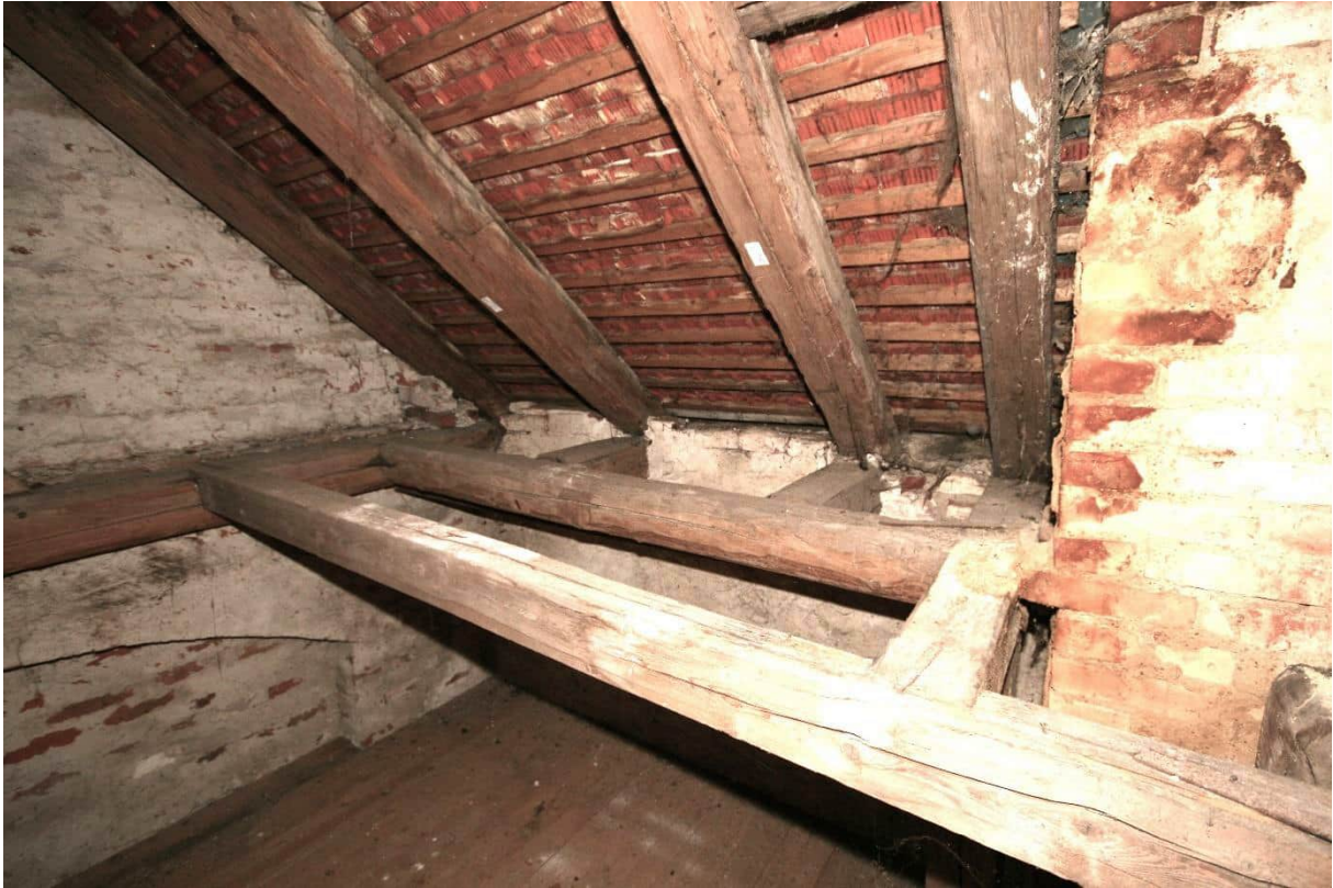
Foto Nr. 45 R.1.11 nach Nordosten: Vor den Wechsel mit Stichbalken ist wegen der späteren Kaminführung ein weiterer Wechselbalken eingebaut worden;
