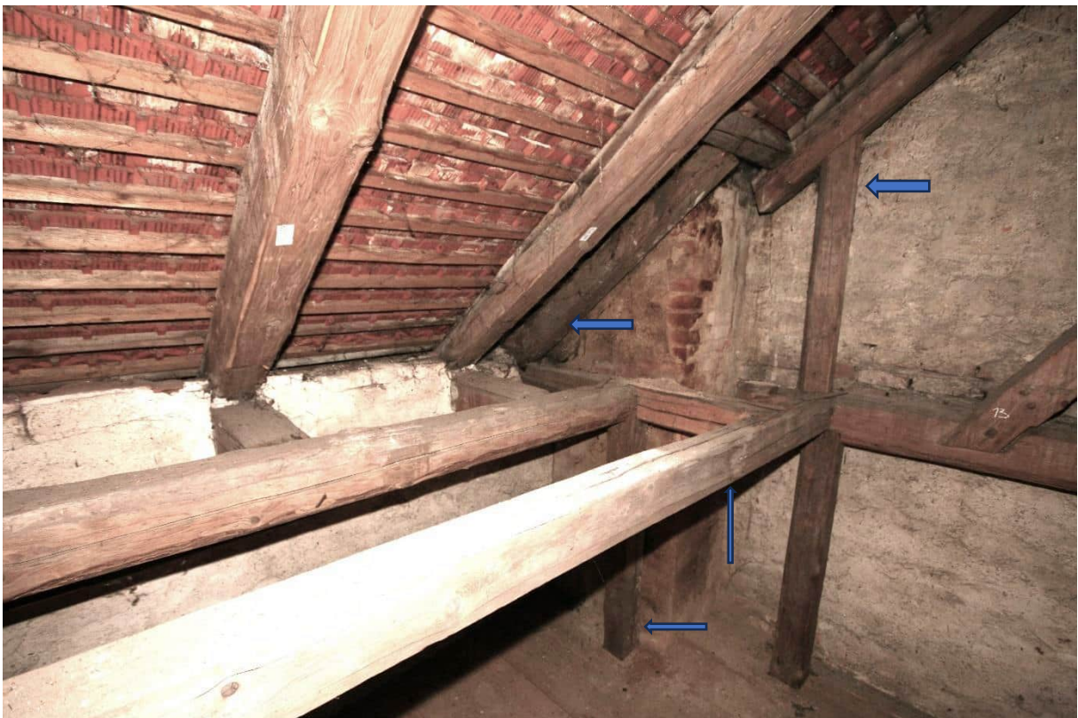
Foto Nr. 46 R.1.11 nach Südosten: dito Foto Nr.45, wegen der Kaminführung wurden Sparren/ Balken abgetrennt, ergänzt, unterfüttert u.s.w.
