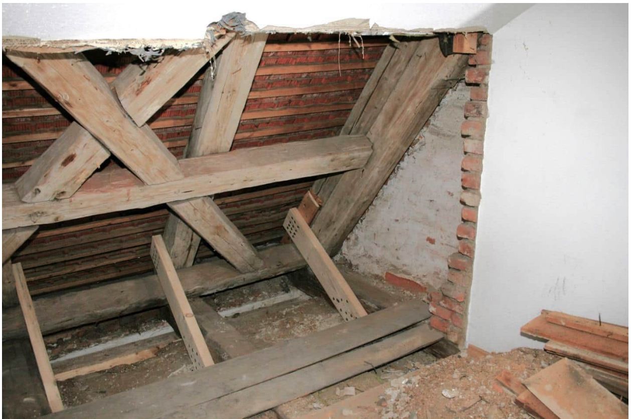
Foto Nr. 91 DG1, Raum Nr. 3.01 nach Südosten: Ausschnitt Bundachse 1= liegende Stuhlsäule, Sparren, Brustriegel, Kreuzstrebenpaar, Fünfeckschwelle, Zerrbalken sowie seitliche Sicherungsbeilasungen,
