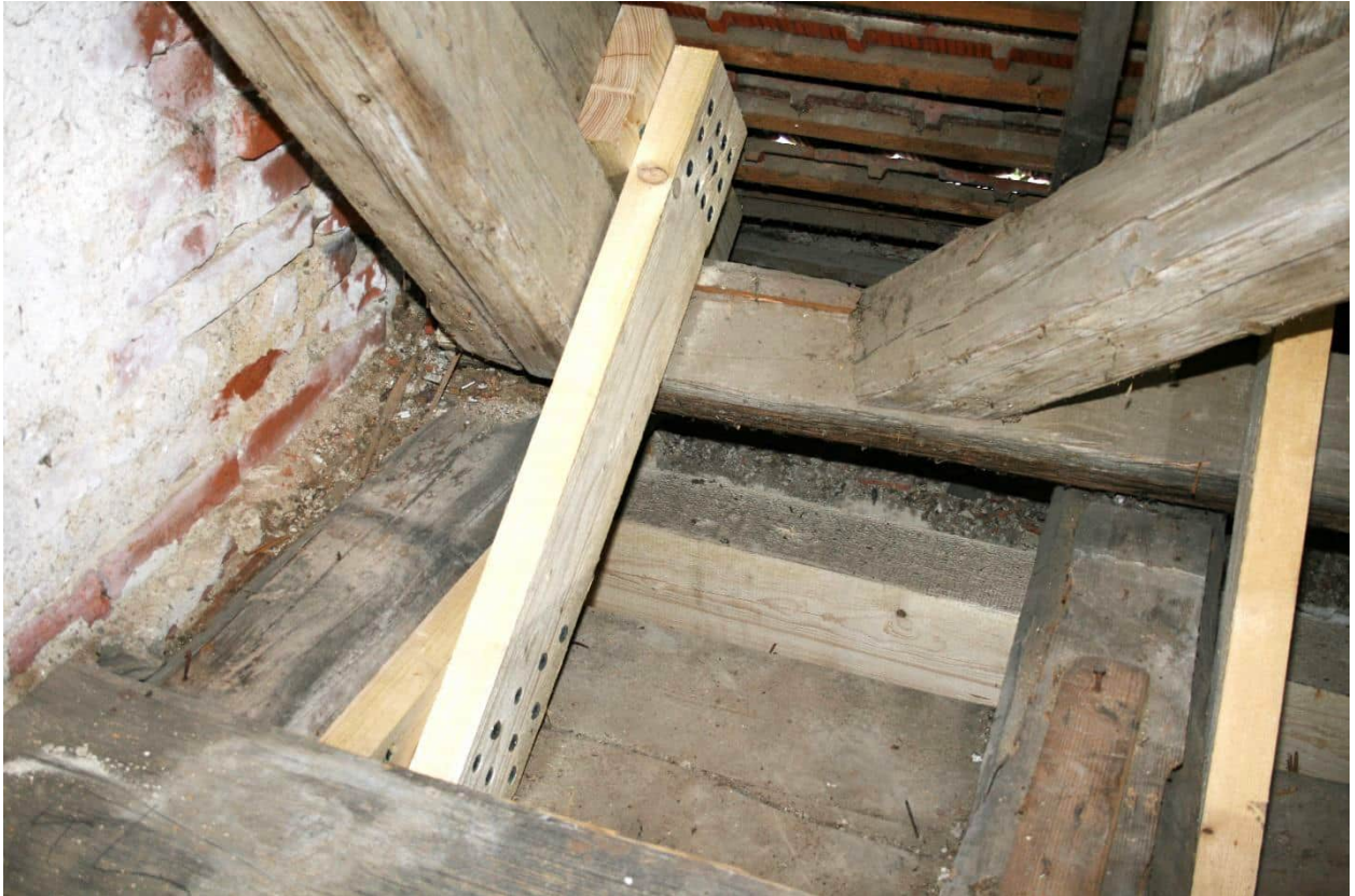
Foto Nr. 118 DG1, Raum Nr. 3.04 nach Nordosten: Detail Traufpunkt Bundachse 5 mit Fünfeckschwelle, Stuhlsäule, Sparren, Zerrbalken und seitlichen Sicherungsbeilaschungen;
