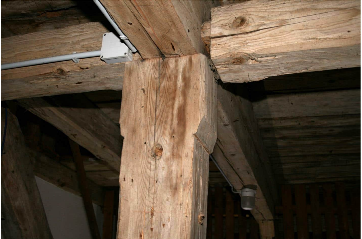
Foto Nr. 110 DG1, Raum Nr. 3.04 nach Südwesten: Detail Mittelstützenkopf verbreitert und darüber Längsrähm, Einzapfung des Bundbalkens in Rähm;
