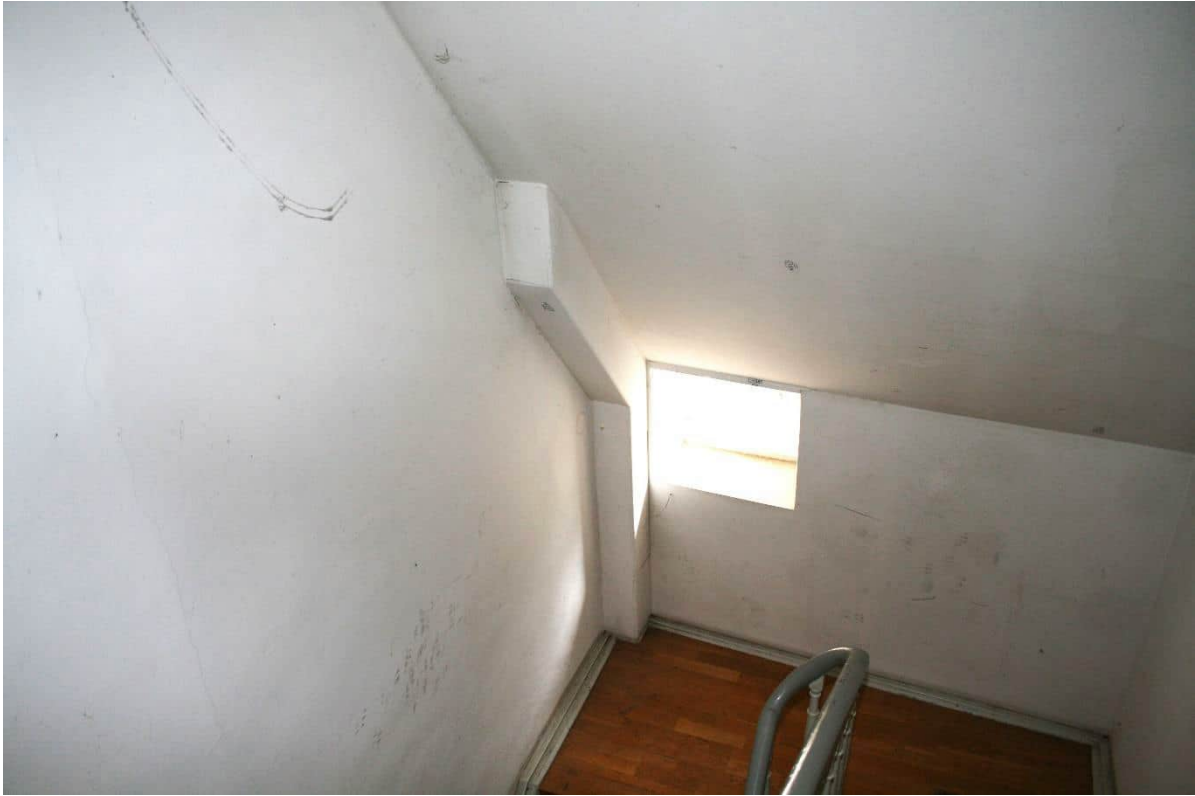
Foto Nr. 120 OG1/DG1, Übersicht Querflur Raum Nr. 3.00 nach Nordosten: Zwischenpodest mit ummanteltem Lüftungsschacht (?);
