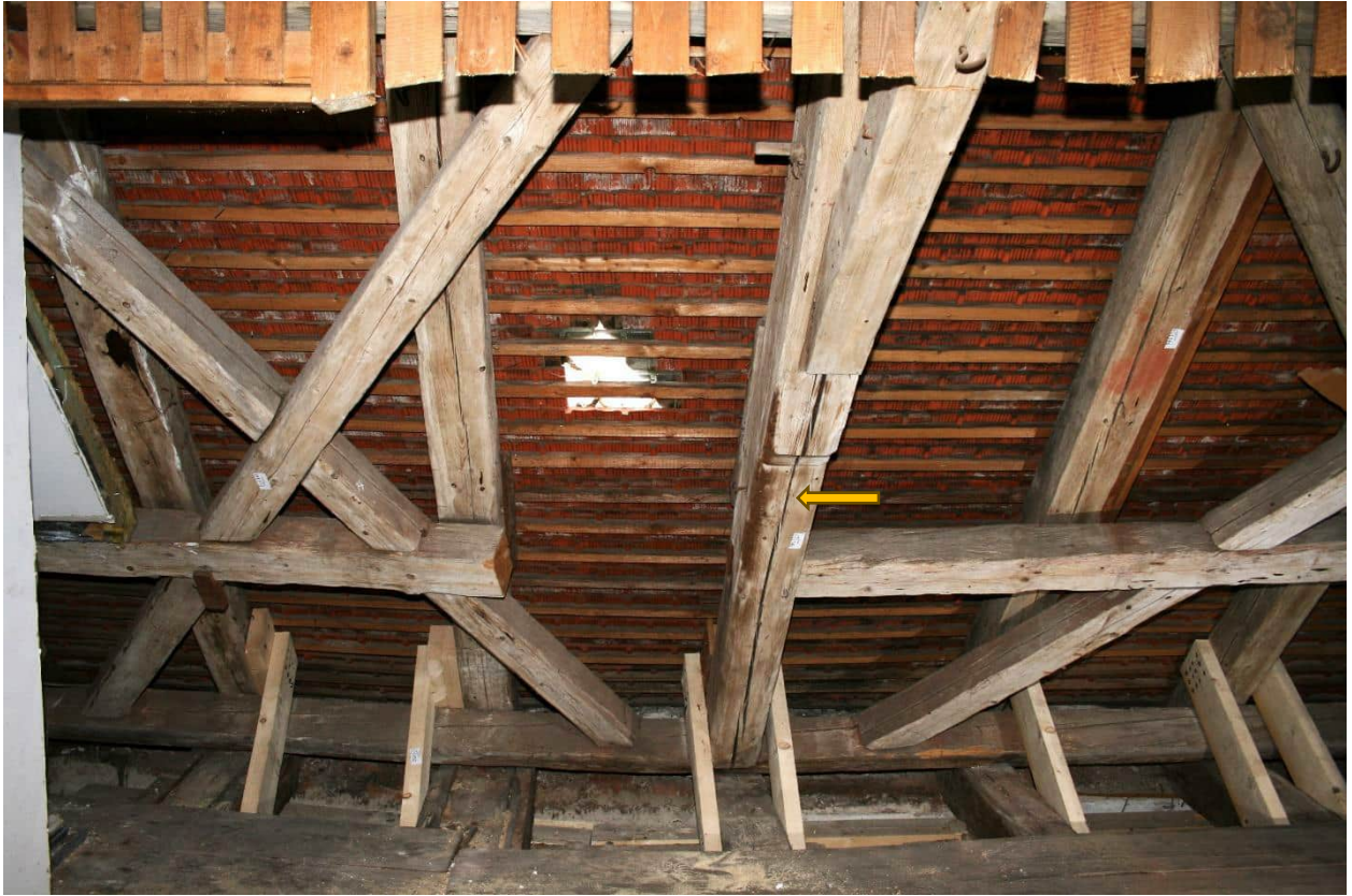
Foto Nr. 104 DG1, Raum Nr. 3.04 nach Westen: Pfeil= Bundachse 4, Abgeschnittener Brustriegel zwischen Spa 09* und Spa 10*;
