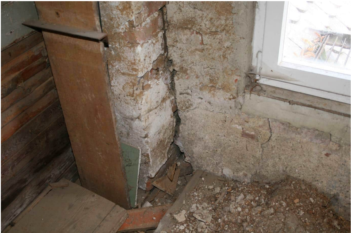
Foto Nr. 117 DG1, Raum Nr. 3.04 nach Nordwesten: Wandpfeiler mit durchgehendem, senkrechtem Putz- und Mauerwerksriss;
