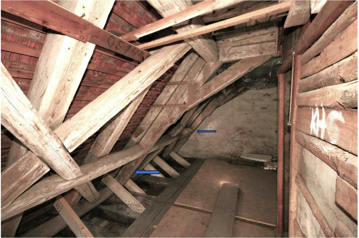
Foto Nr. 115 DG1, Übersicht Raum Nr. 3.04, östliches Dachwerk nach Süden, Pfeile= Bundachsen 4 und 3;
