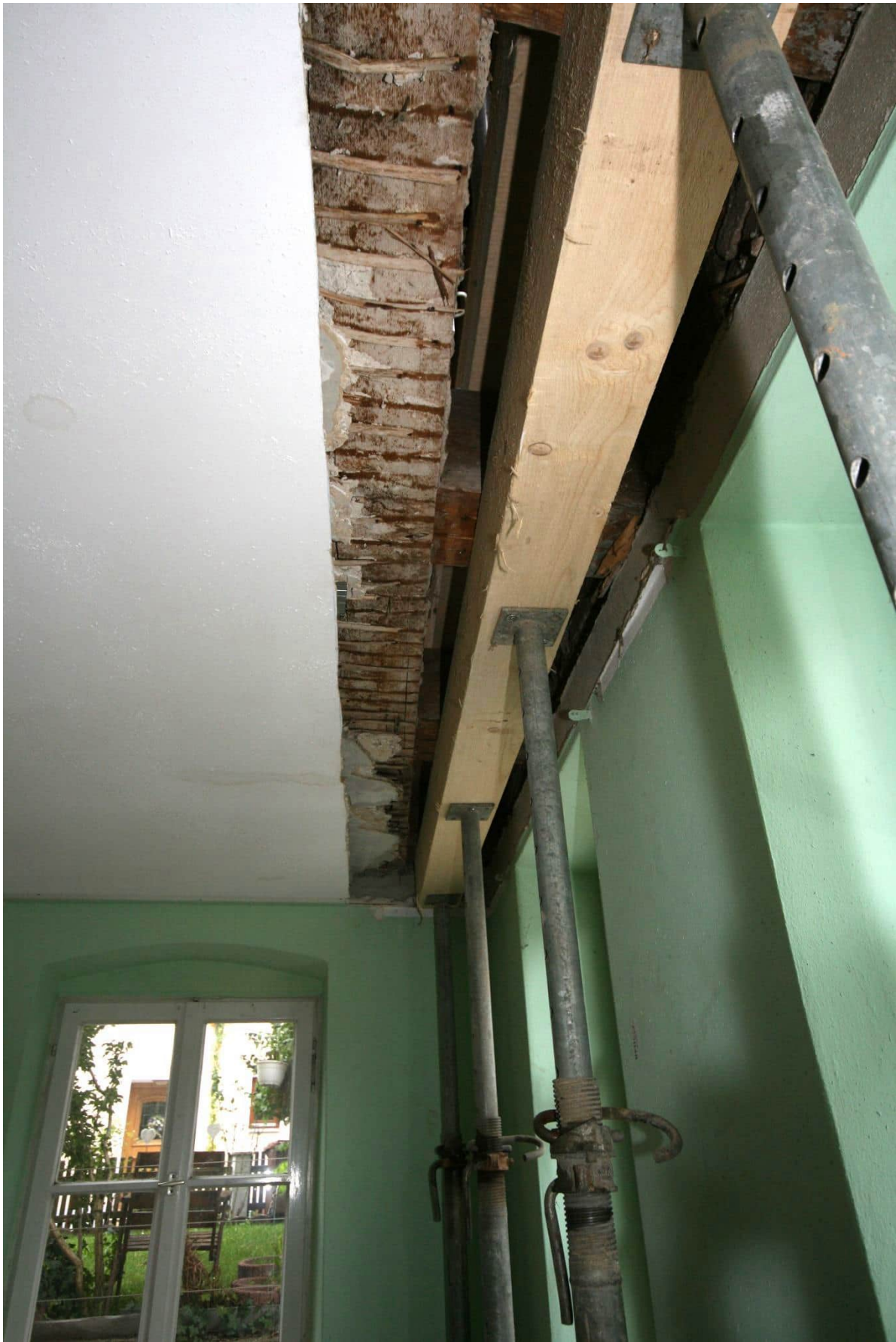
Foto Nr. 66 EG, Raum Nr. 0.01 nach Süden, Deckenausschnitt: Putzdecke mit Haselruten auf Brettern, als Putzträger unter Gipskartondecke auf Trägerkonstruktion mit darüber liegender Deckenbalkenlage wie vor;
