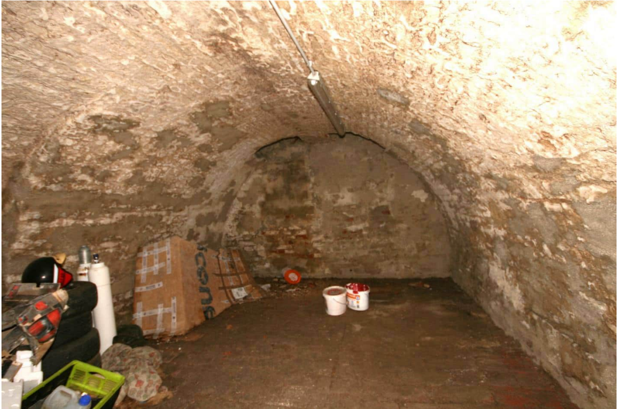
Foto Nr. 54 KG, Raum Nr. -1.01 nach Süden: Tonnengewölbe mit tief ansetzendem Kämpfer, Vollziegel gemauert und mehrmals geschlämmt; Boden: Vollziegel;
