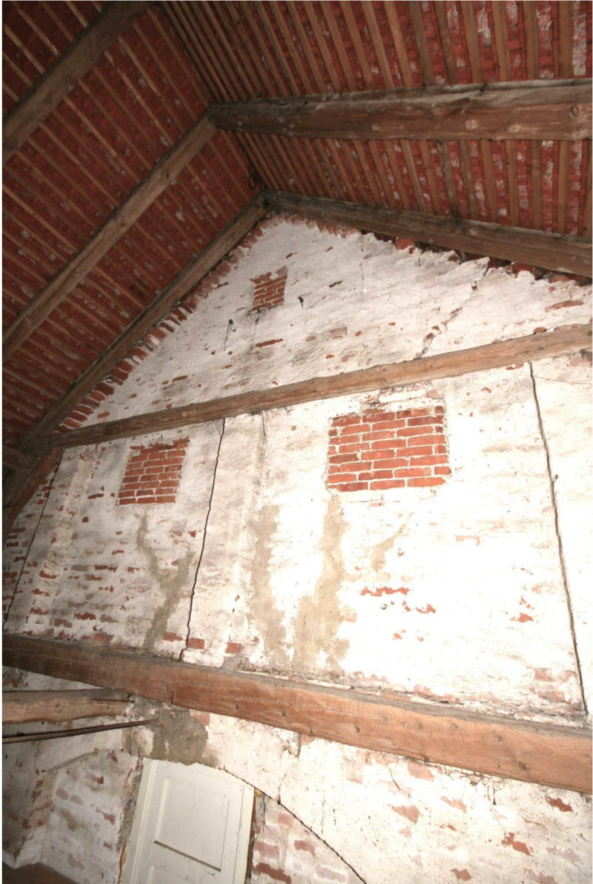
Foto Nr. 49 R.1.11 nach Nordwesten: nördliche Außenwand mit zugesetzten Fenstern; gemauerte Pfeilervorlagen Der Wandscheibe sitzen auf Zerrbalken;
