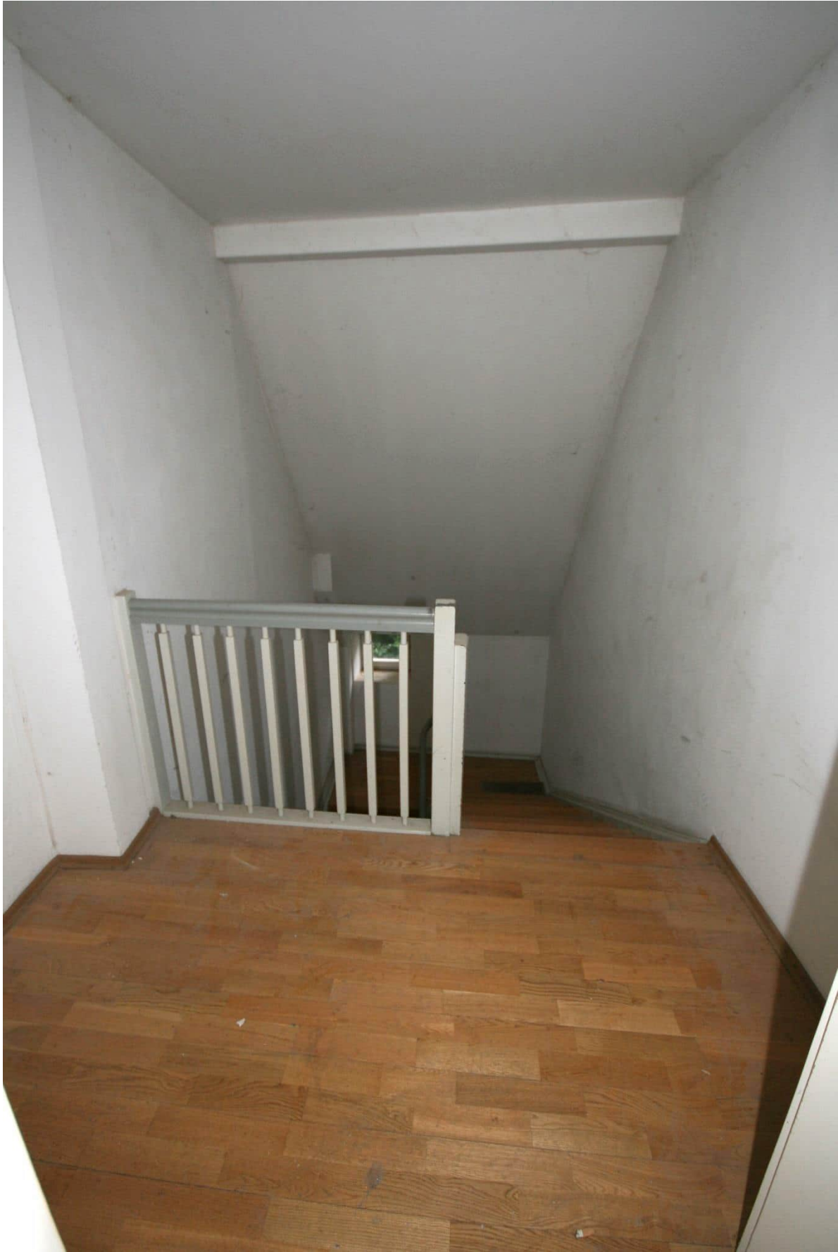
Foto Nr. 88 DG1, Übersicht Querflur Raum Nr. 3.00 nach Osten: Holzwangentreppe mit Tritt- und Setzstufen, zweiläufig mit Zwischenpodest;
