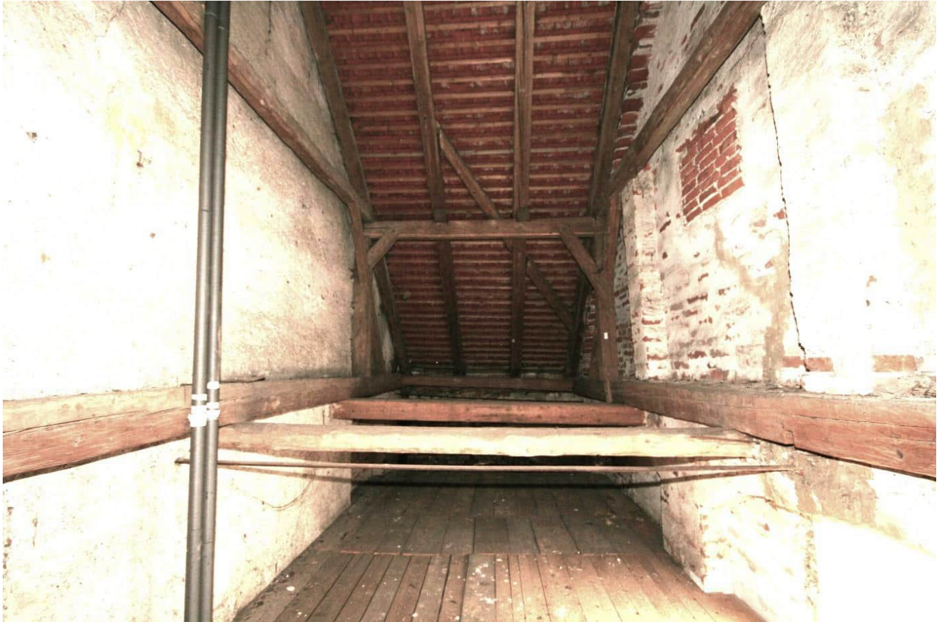
Foto Nr. 32 Übersicht R.1.11 nach Westen: Stehender Kehlbalkenstuhl mit zwei Bundachsen, die Längsaussteifung (in Firstrichtung) geschieht über hoch ansetzende Kopfbänder, die Queraussteifung über Steigbänder (jeweils mit leichtem Versatz); die Verbindungen sind verblattet und mit Holznägeln gesichert; die Ständer sitzen auf Zerrbalken, die vor der nördlichen und südlichen Wandscheibe laufen; unter den Zerrbalken sind Balken gelegt, die auf den Wandscheiben lagern; die Zerrbalken der Zwischengesparre sind beidseitig als Stichbalken in einen Wechselbalken gezapft;
