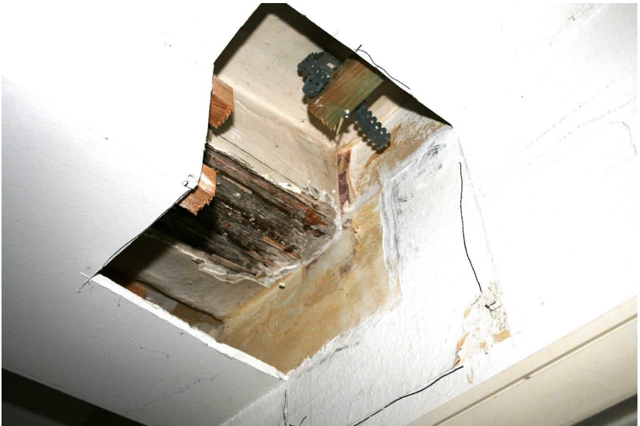
Foto Nr. 87 OG, Raum Nr. 1.07 nach Südosten: Deckenausschnitt: Balkenunterzug und Decke mit Fassungen wie vor;
