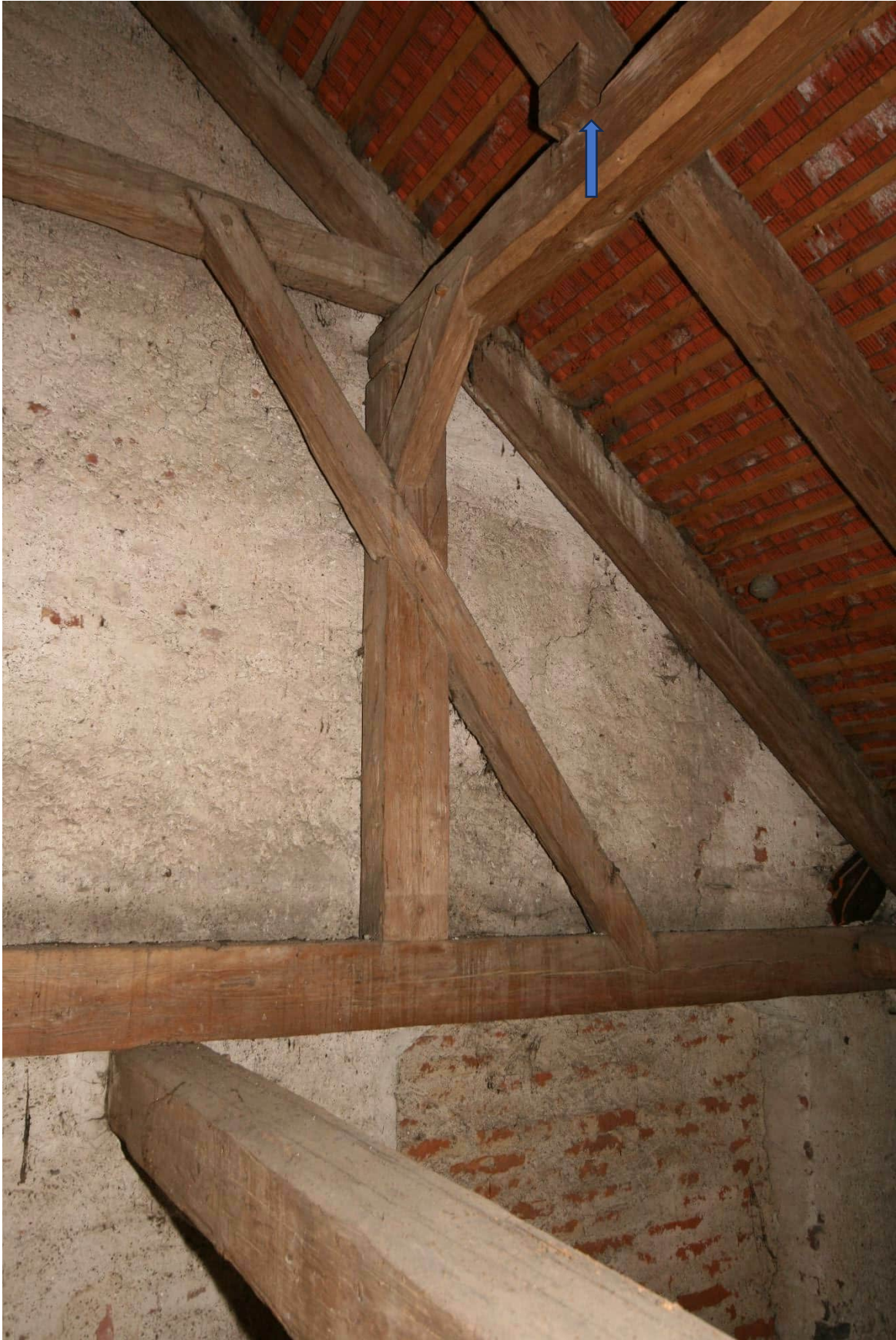
Foto Nr. 35 R.1.11 nach Südwesten: Stehender Kehlbalckenstuhl, hier die südwestliche Bundstütze in den Zerrbalcken gezapft; Sicherungen wie nordwestliche Bundstütze; Pfeil= Kehlbalcken abgetrennt (!)
