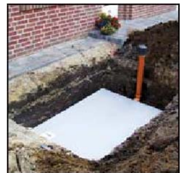
Versickerungselement mit Filtervlies überdeckt
