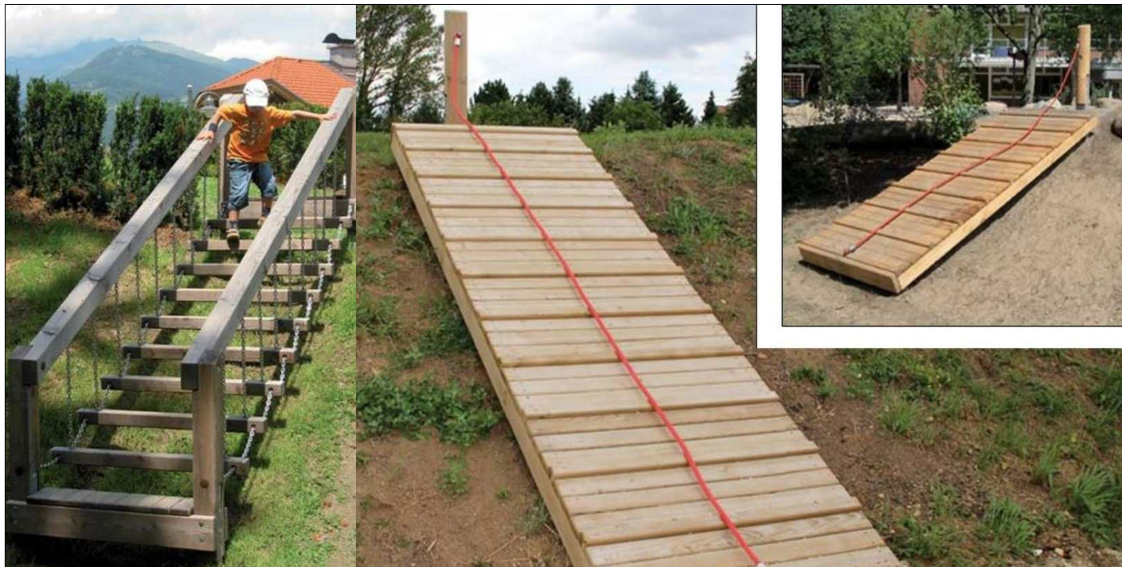
Kettentreppe Aufstiegsmöglichkeit für Böschung
